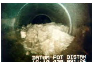
[Lokale Verstopfungen/Ablagerungen durch falsches Wassersparen. Die Wasserspülung ist zum Abtransport grober Stoffe ungeeignet!
